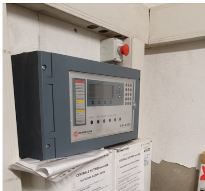
Centralina impianto rilevazione incendi ed EVAC – Locale tecnico PT, vano scale portineria 2
